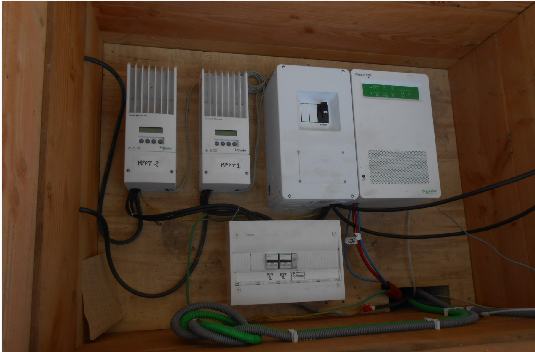
On observe sur cette photo le module de traitement de l'électricité. Il s'agit d'un ensemble de composants d'électronique de puissance (onduleur, contrôleur de charge, disconnecteur, etc..).
