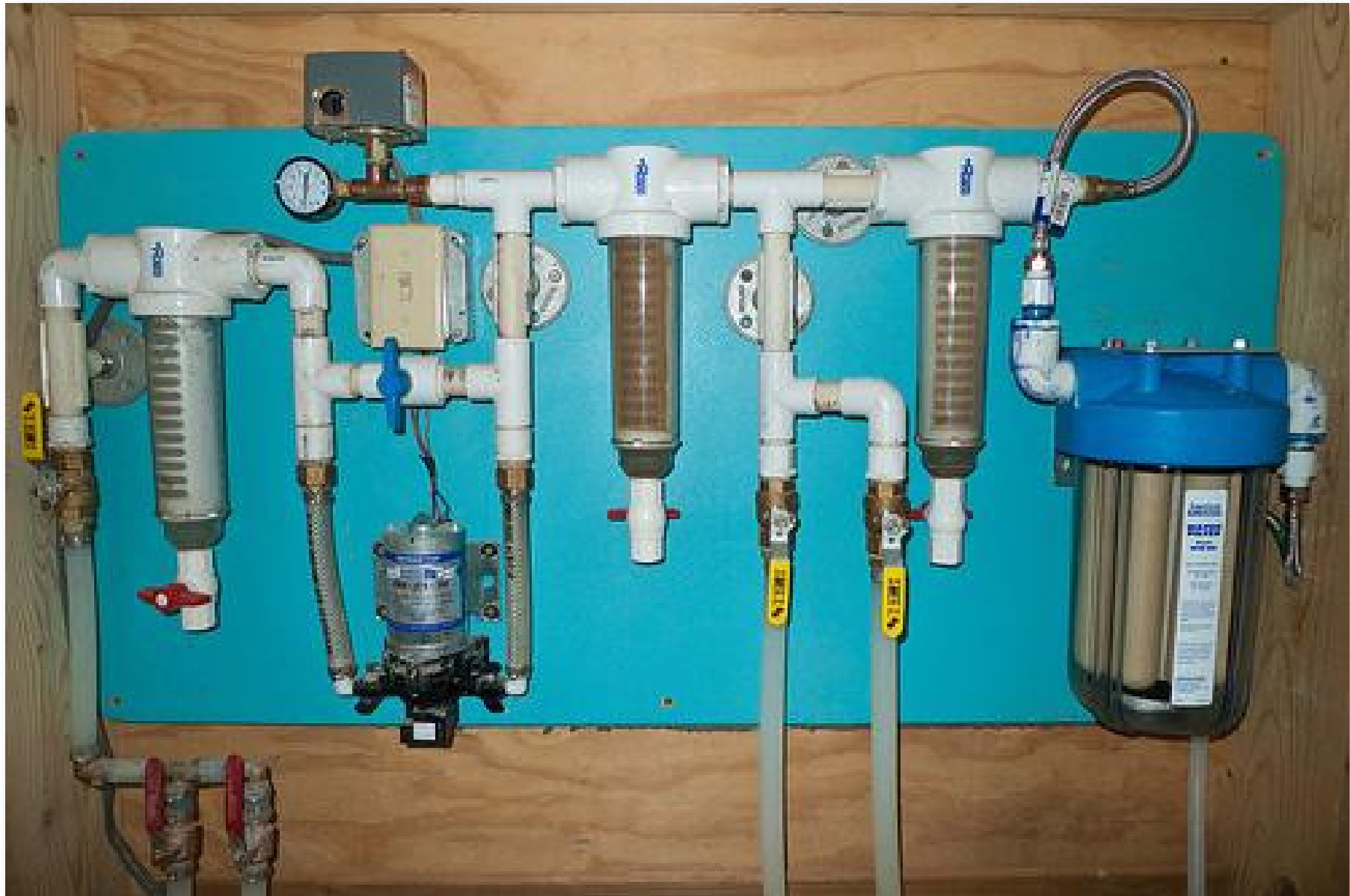
Il s'agit là du module de traitement de l'eau. L'eau des citernes passe par une succession de filtres et une pompe afin d'être consommable et pressurisée.
